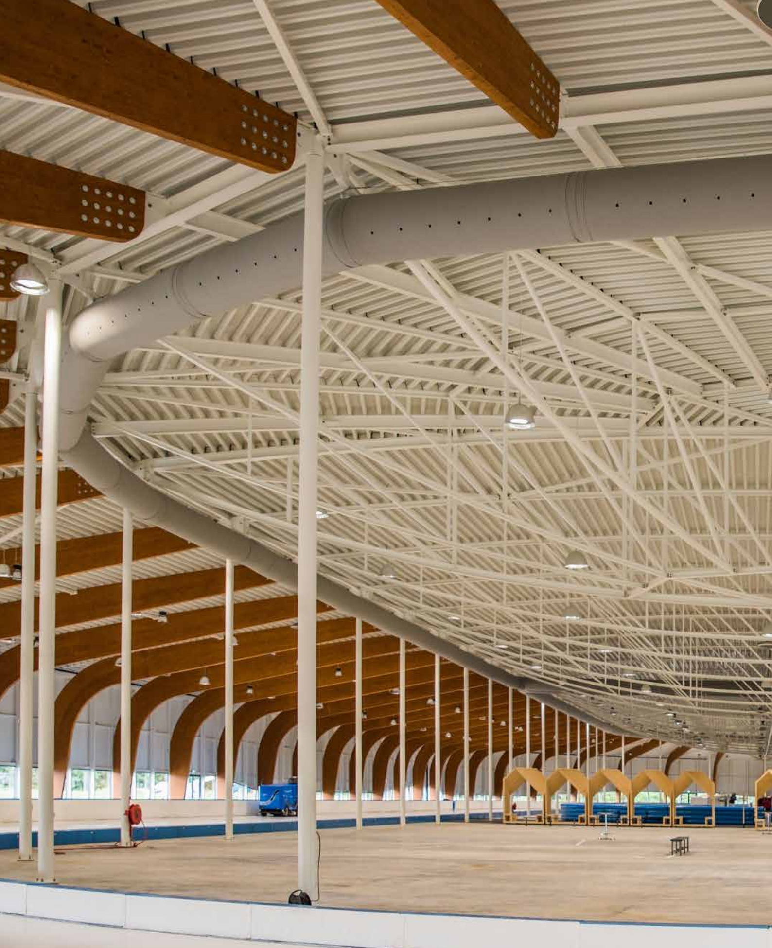
LUCHTVERDEELSLANGEN IJBAAN ELFSTEDENHAL | LEEUWARDEN
